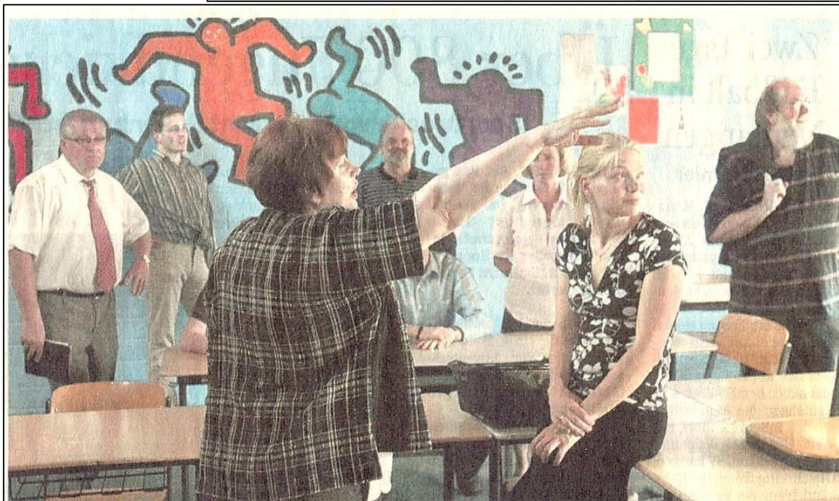
Wegen der durch Teppich und Holzverkleidung angenehmen Akustik bildet dieser Raum für Erika Behrens zwar eine positive Ausnahme. Aber perfekt ist er nicht: Sie weist die Politiker auf undichte Fenster und fehlende Jalousien hin. Foto: Anne Diekhoff
